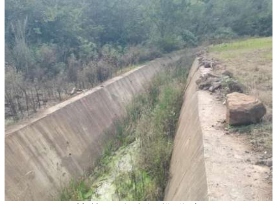
桂林泵站渣场排洪沟
